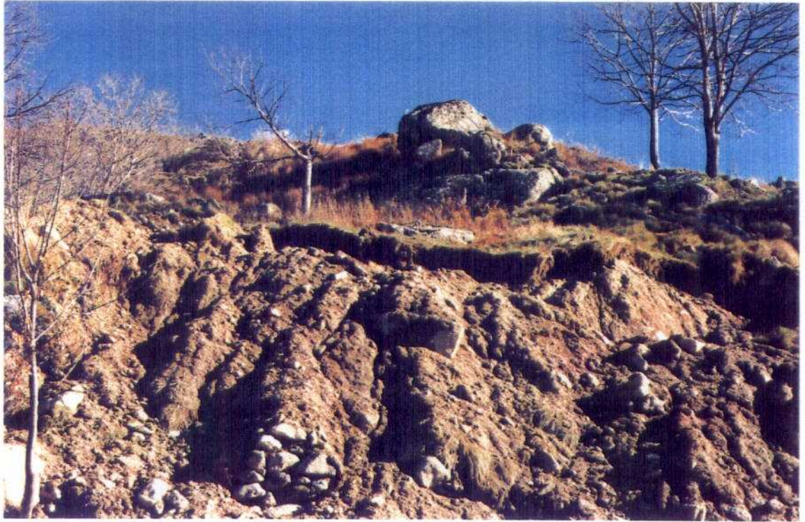
Fotografía nº 9: Vista de un gran bloque por encima del deslizamiento I inestable, que deberá ser saneado. Entre la carretera y el bloque aparece una cuneta abierta para desviar la escorrentía superficial fuera de la zona deslizada.
