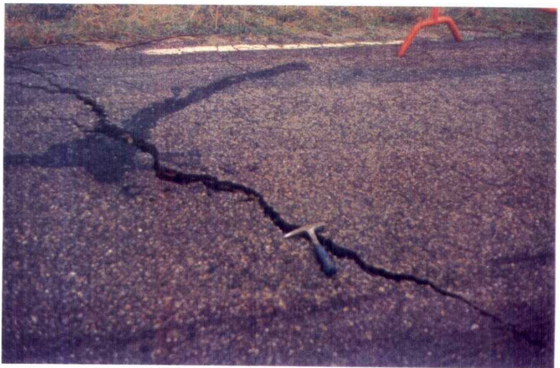
Fotografía nº 10: Vista de la grieta de tracción del deslizamiento II, y que afecta a la carretera.
