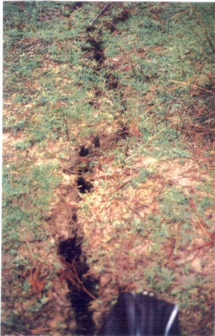
Fotografía nº 7: Grieta longitudinal del deslizamiento I, realizado junto a los pinos existentes en la zona media.
